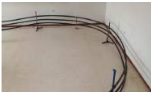
Pipeline in PEHD
